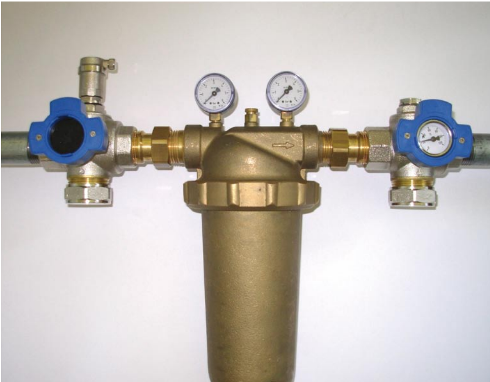
Große und effiziente Heizungsfilter – wie hier in der Abbildung eingebunden mit Spülstutzen in Dimension der Leitungsgröße, zum Rückspülen des Filters bzw. als Füll- und Spülstutzen für die Anlage – empfiehlt die Norm und schützen das System.
